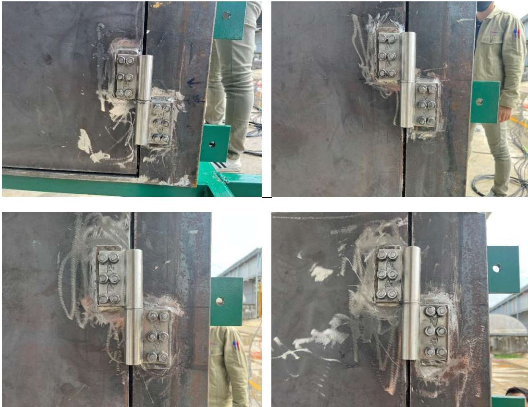
รูปที่ 1 ตรวจสอบความเสียหายบริเวณบานพับหลังทำการทดสอบ
